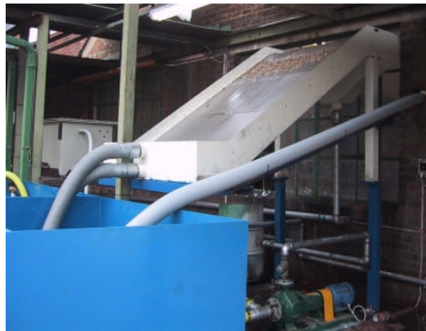
Figura 9 – Tanque de água e Peneira Side Hill
